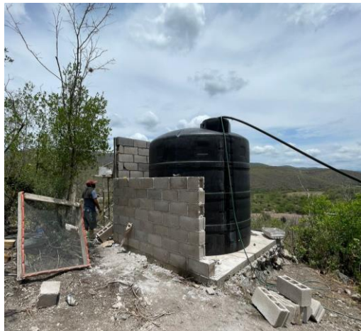
READECUACION DE TANQUE DE ALMACENAMIENTO DE LA COMUNIDAD DE MOJARRAS DE ABAJO.
